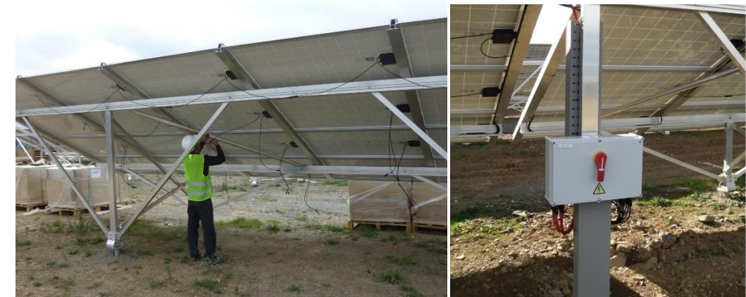
Photographie 15. À gauche : Câblage des panneaux - A droite : Boîtier de raccordement - RES
